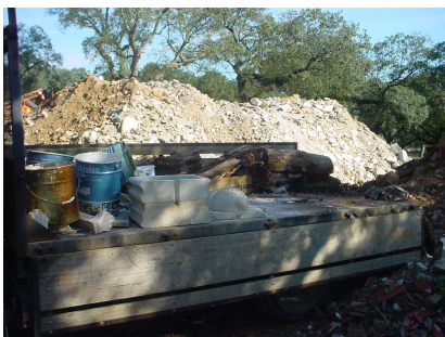
Figura 5.3 – Exemplo de carga de resíduos que foi rejeitada, devido à presença de RCD não inertes.
