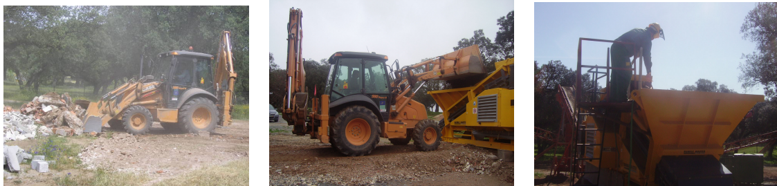
Figura 4.5 – Alimentação do sistema de reciclagem
