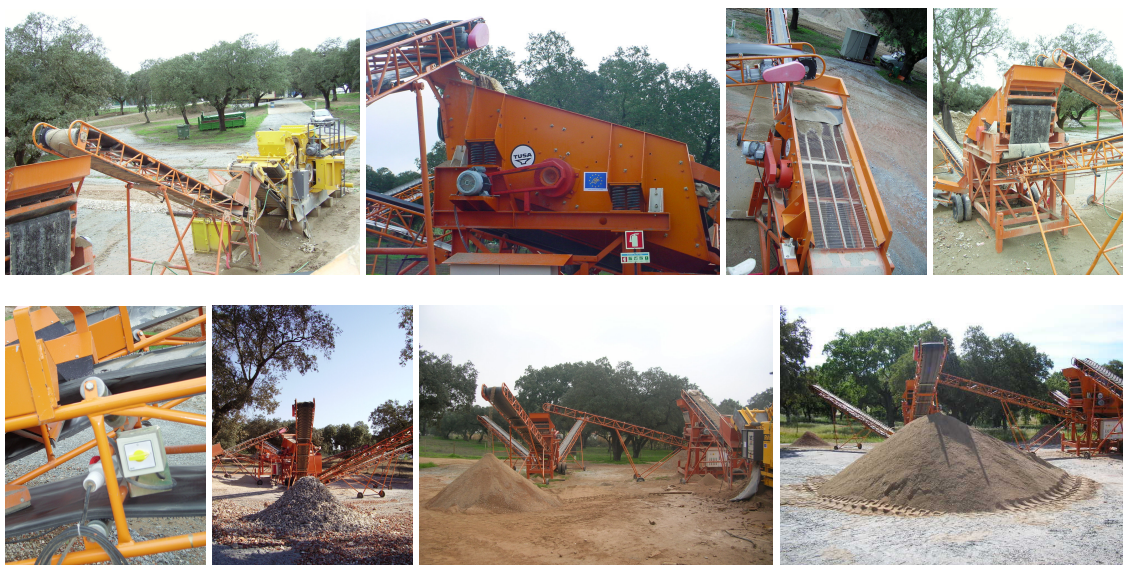
Figura 4.7 – Aspectos gerais do sistema de crivagem instalado.
