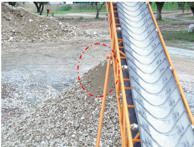
Figura 6.9 – Aspecto do material de granulometria 4-8 mm contaminado com materiais mais finos, devido a problemas de colmatção nos crivos e à elevada humidade dos RCD reciclados.
